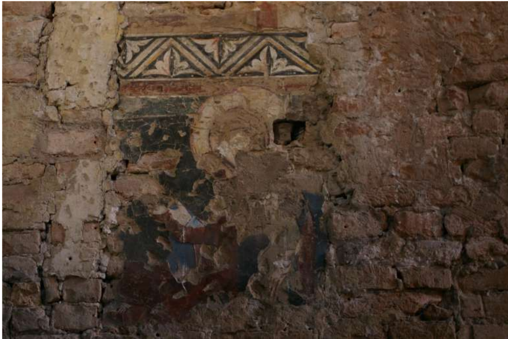
Fig. II.37: uno dei lacerti di affresco della parete ovest dove si possono riconoscere diverse fasi decorative.
