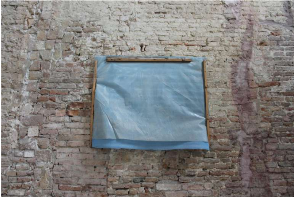
Fig. II.18: una delle coperture in gomma-piuma a protezione dei lacerti di affresco.
