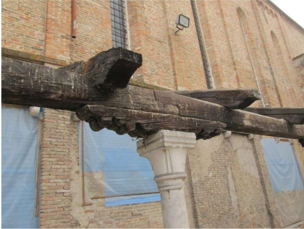
Fig. II.23: dettaglio delle travi lignee ammalorate e di una colonna durante le fasi di rimozione del portico.
