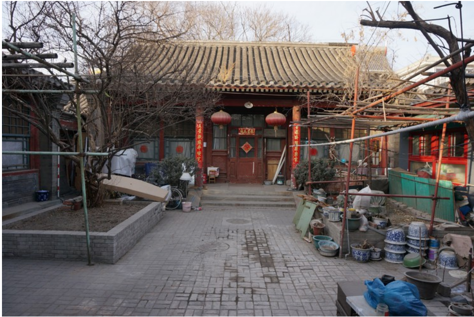
Immagine 8: Cortile in cui sono in corso dei lavori per l'edificazione di nuove strutture
