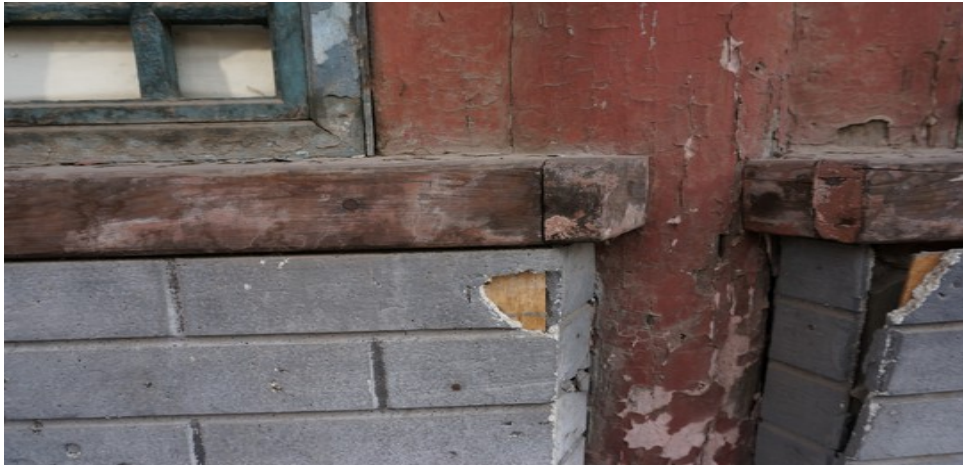
Immagine 9: Il muro di questo edificio è coperto da un'asse di compensato, rivestita da polistirolo colorato in grigio per coprire il muro rovinato e sembrare simile al muro originario, in mattoncini grigi
