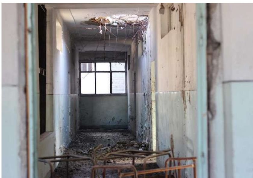
Figura 1 - Condizioni delle strutture scolastiche dopo i bombardamenti dal 2011 ad oggi
