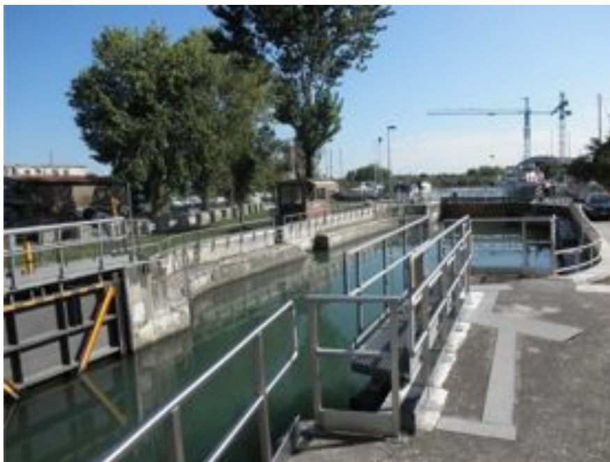
La conca di navigazione di Portegrandi. Sullo sfondo, oltre la porta, si allunga il canale Silone
