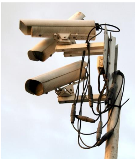
Fig. 3 Videocamere di sorveglianza cablate a circuito chiuso.
