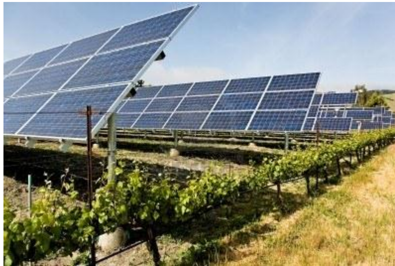
Figura 3-7. Pannelli fotovoltaici in vigneto, California
