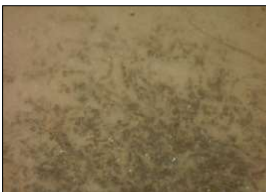
Punto 5: verso, residuo sotto macchia lato sinistro
