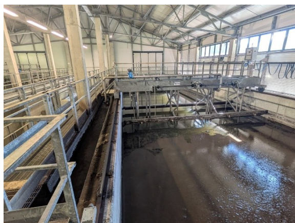
Sedimentatore con ponte mobile aspiratore
