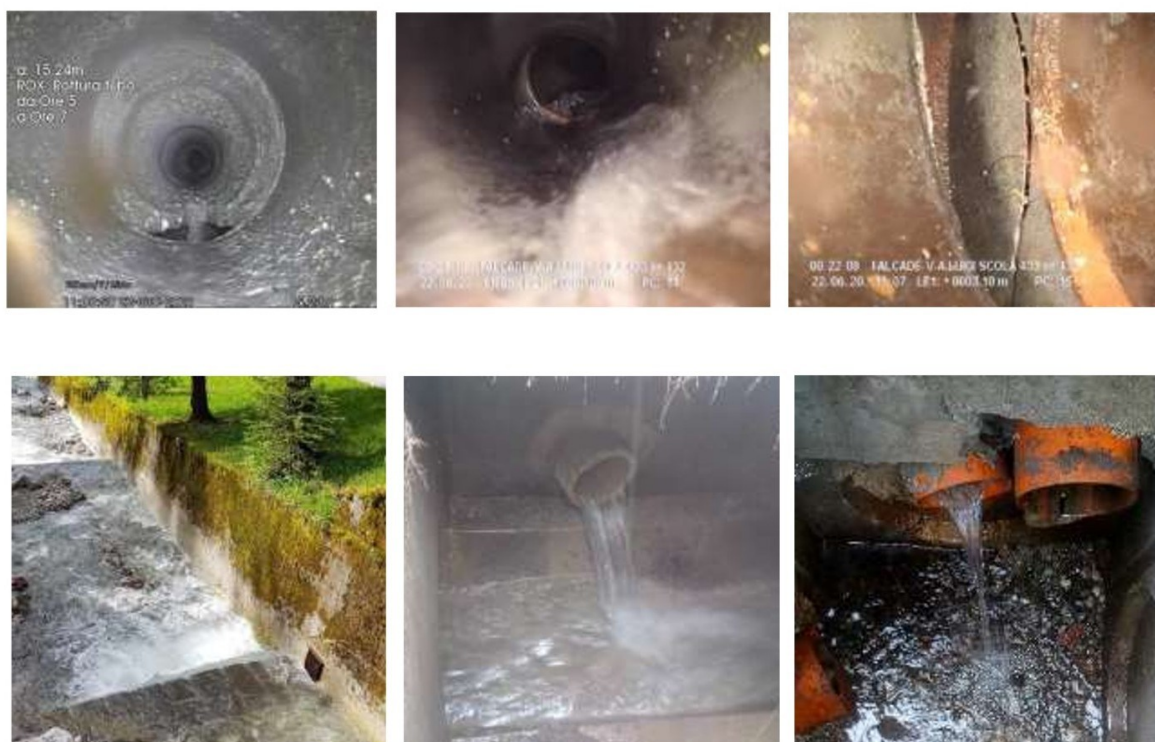
Fig. 6. – Falcade: esempi di infiltrazioni dovute a rotture o disallineamenti delle tubature. E sotto esempi di afflussi da sottobacini scolanti, drenaggi in fognatura mista e una canalizzazione superficiale.
