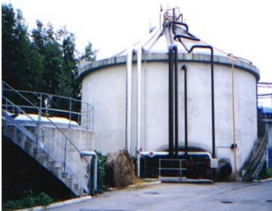
Figura 3.1: digestore anaerobico del WWTP di Treviso
