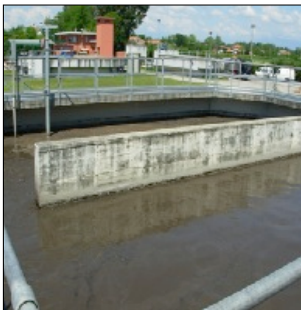
Figura 3.3: Ispessitore statico a gravità del WWTP di Treviso
