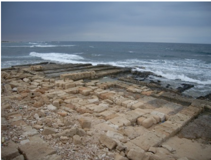
Fig. 45 – L'immagine mostra quanto il sito di Sabratha sia fortemente degradato dall'azione erosiva delle onde, che si infrangono continuamente sulle strutture costiere (foto gentilmente concessa dal prof. Beltrame).
