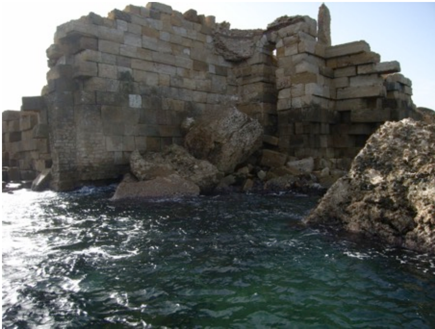
Fig. 47-49 – Il faro, situato all'ingresso del porto di Leptis Magna, gravemente danneggiato dall'erosione costiera e minacciato dal sollevamento del livello del mare (foto gentilmente concesse dal prof. Beltrame).
